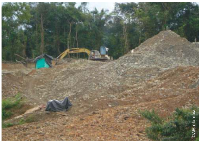
Una mina ilegal causando deforestación y contaminación de agua
